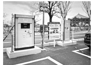
EV充電施設
